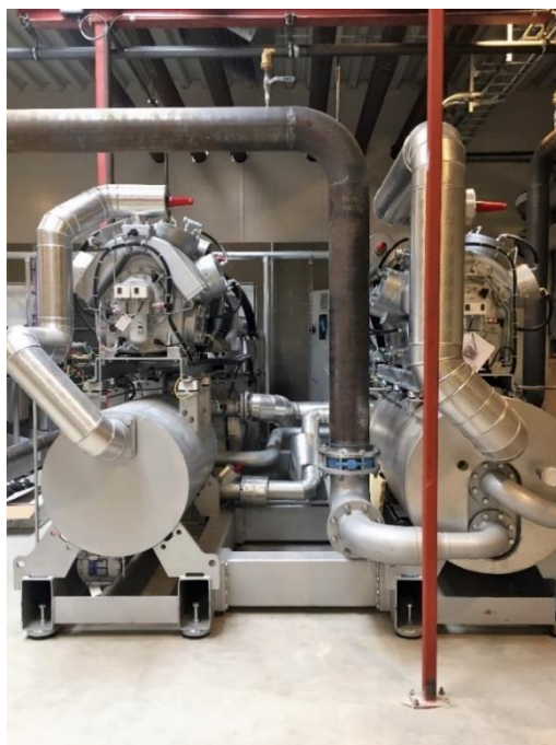
3 Her ses en del af Kalundborg Forsynings nye varmepumpeanlæg
